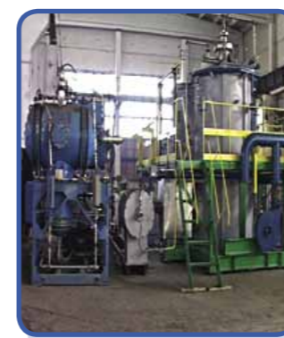
Действующая установка по переработке природного газа в синтез-газ производительностью 100 куб. м/час. Operating facility for conversion of natural gas into synthesis gas with productivity 100 m 3 /h.
